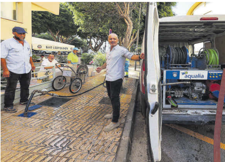
Abajo a la izquierda, el nuevo punto de carga de agua, en la calle Port de la Savina.
